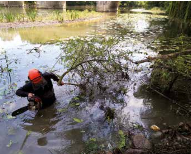
Evacuation arbres coincés à la passerelle de Montbazon
